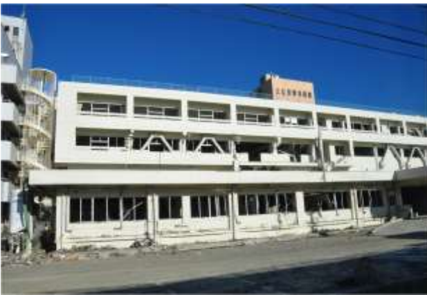
写真-5-3 南三陸町 志津川病院 (2011年10月) 建築研究所国際 地震工学センター撮影
